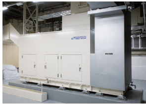
非常用発電機 (ガスタービン)
